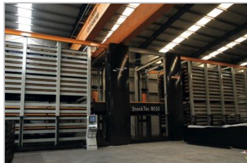
Automatic Storage Almacén automático
