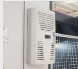
Cabina Electrica con Sistema de Refrigeración
