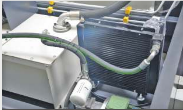
Sistema de Refrigeración del Aceite Hidráulico
